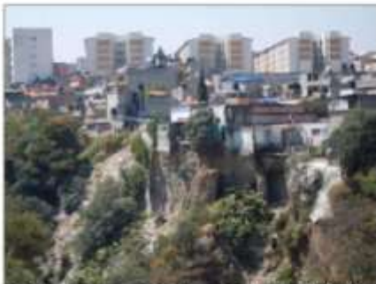
Fig. 1.1. Aspecto de los taludes y de los cortes sin obra adecuada de estabilización. Barranca Santa Rita.
